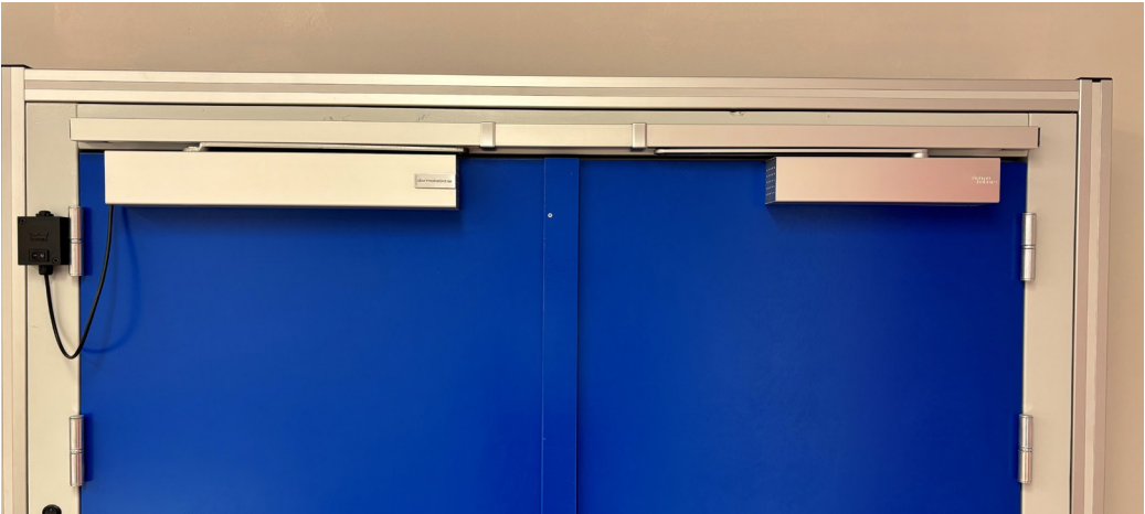
La foto y el ejemplo de la combinación del TS 93 B en la puerta pasiva y el TS 99 FL N en la puerta de paso con el controlador de secuencia de cierre GSR-EMF 1/V
